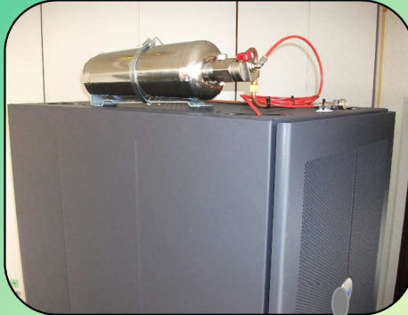
サーバーラック
