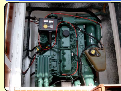
ボート エンジンルーム
