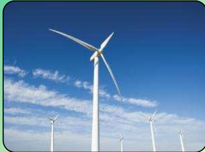
風力発電設備
