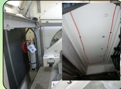
風力発電設備(ナセル内)
