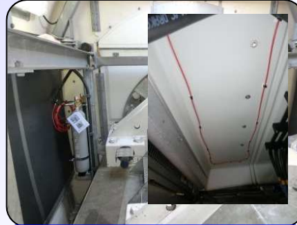
風力発電設備(ナセル内)
