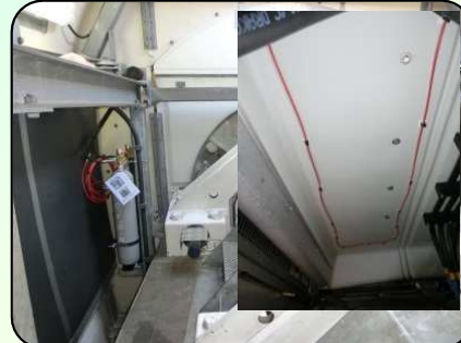
風力発電設備(ナセル内)
